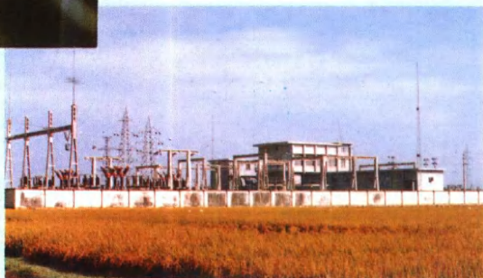
縣第二輸變電站
