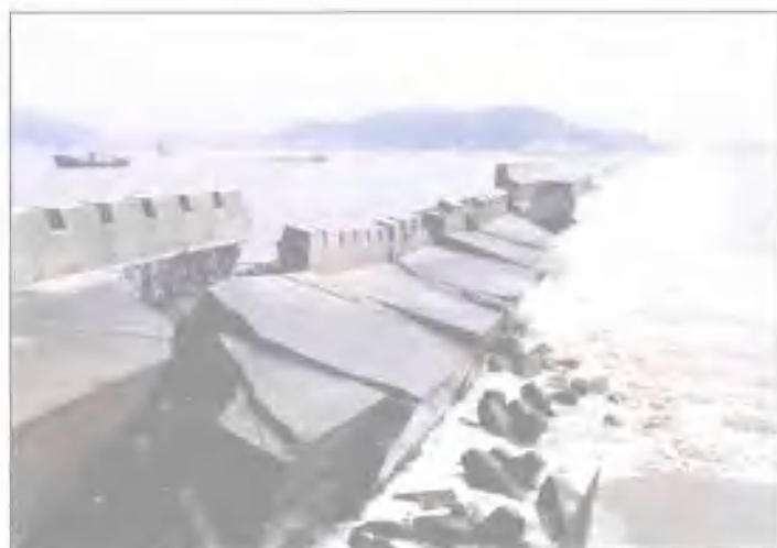
图 9 2002 年 9 月“森拉克”巨浪对浙江玉环 渔港防波大堤造成严重损坏
