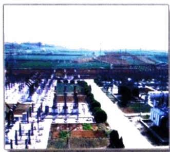
江沟110KV变电站
