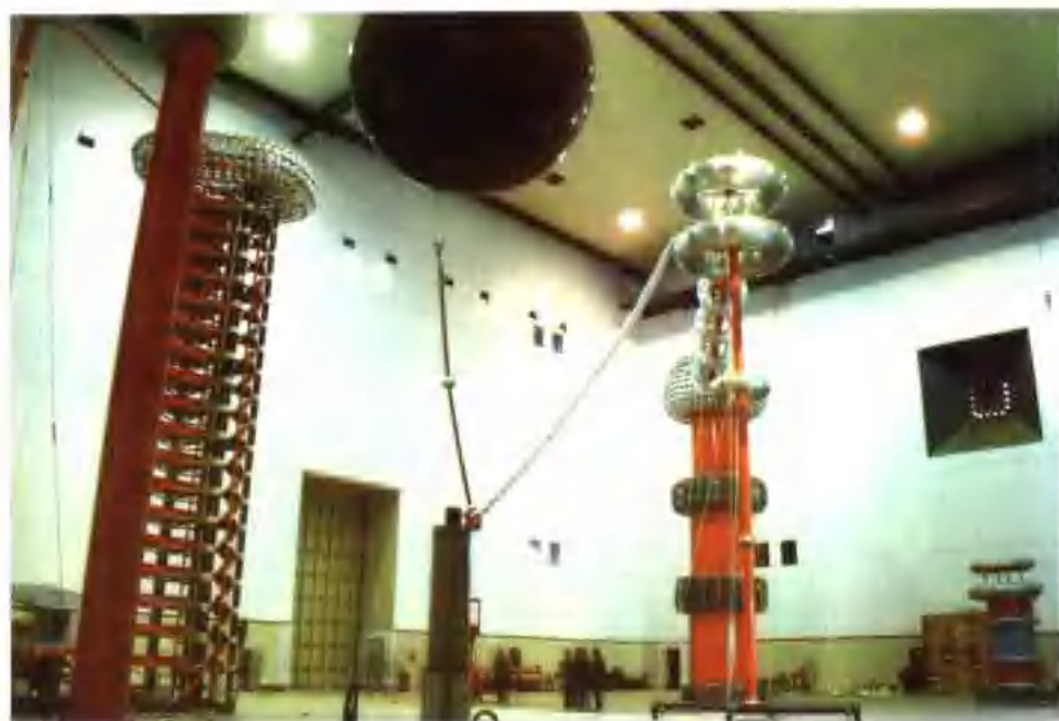
14. 高压试验大厅，可满足500千伏电气设备试验的需要。
