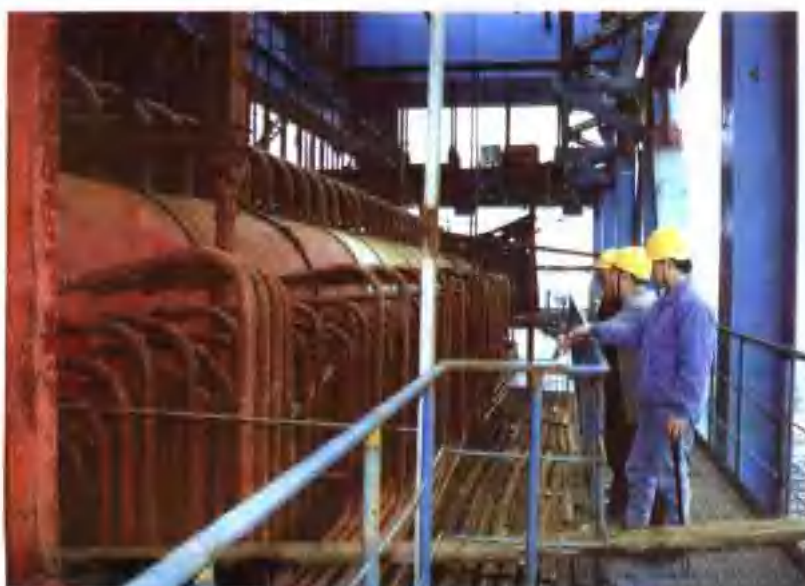
9 在安顺发电厂检查20万千瓦机组的设备状况
