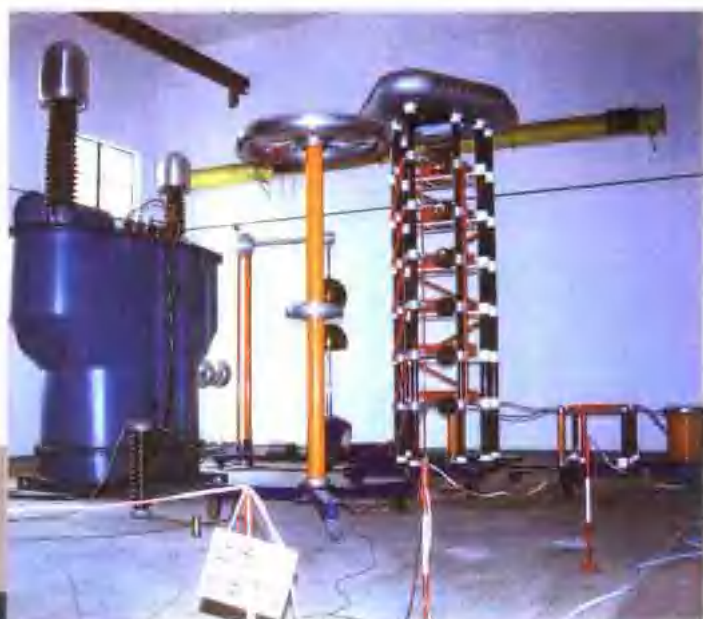
15. 高压试验小厅
