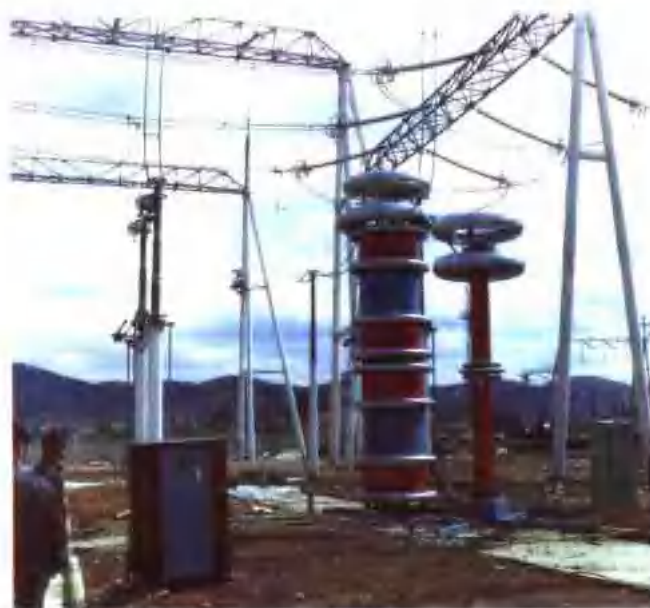
使用 500 千伏工频串联谐振装置，对 500 千伏设备进行耐压试验。
