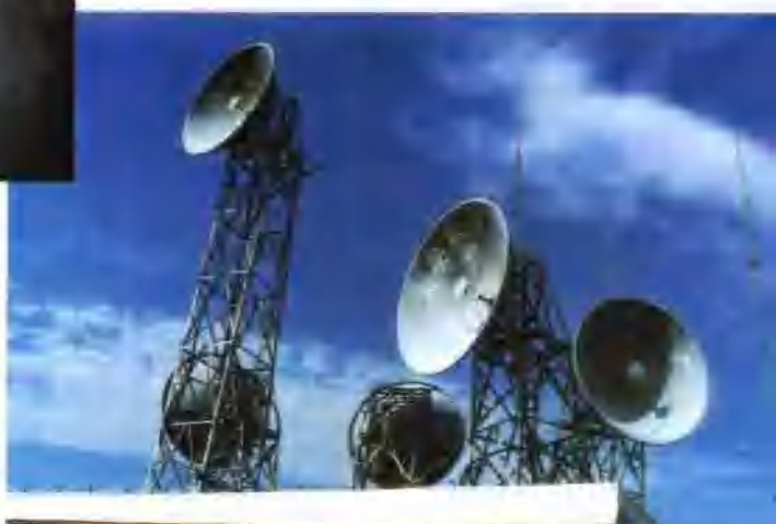
▲农村电话微波枢纽中心 1062 基站
