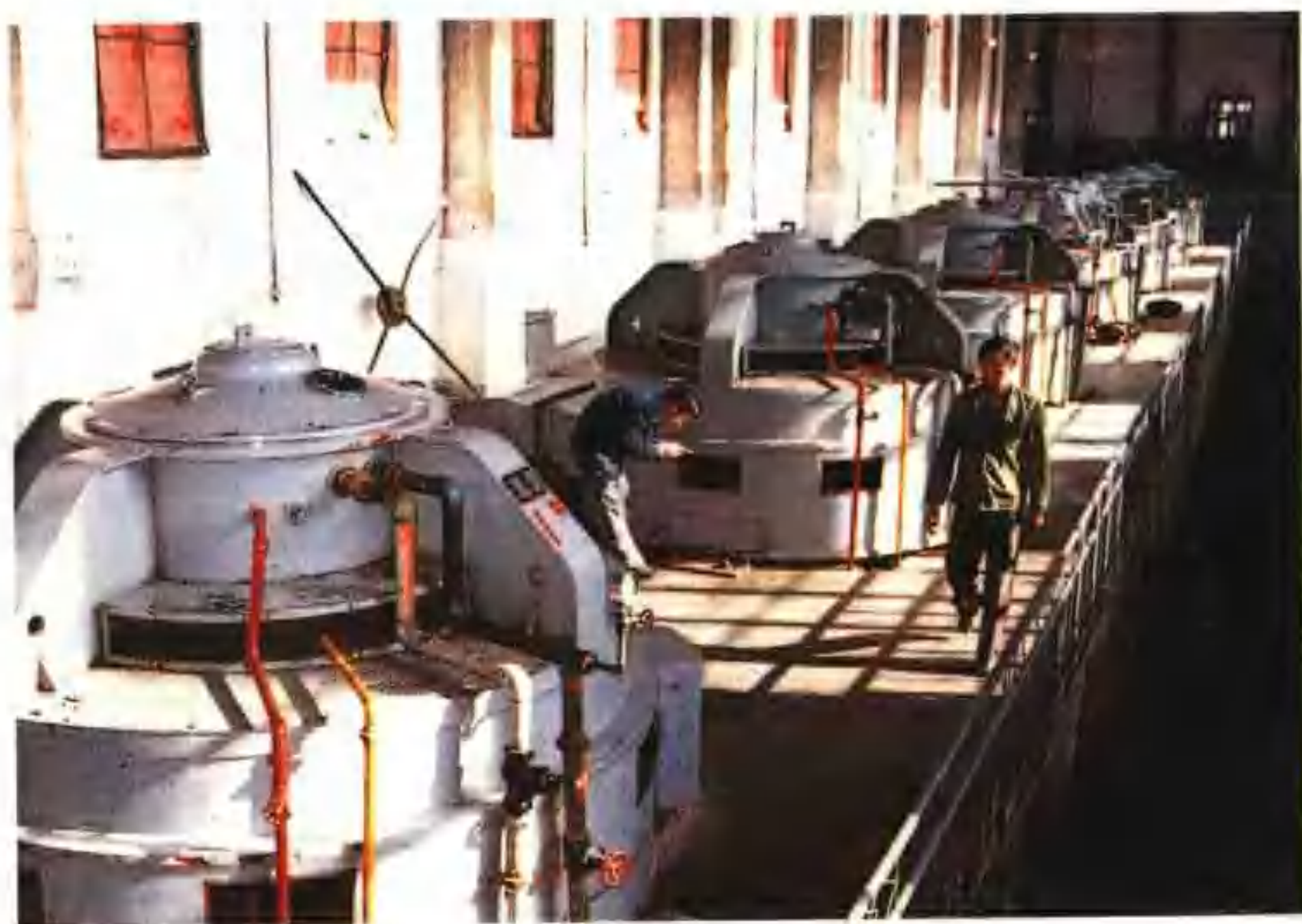
一泵站沅江泵运行情况
