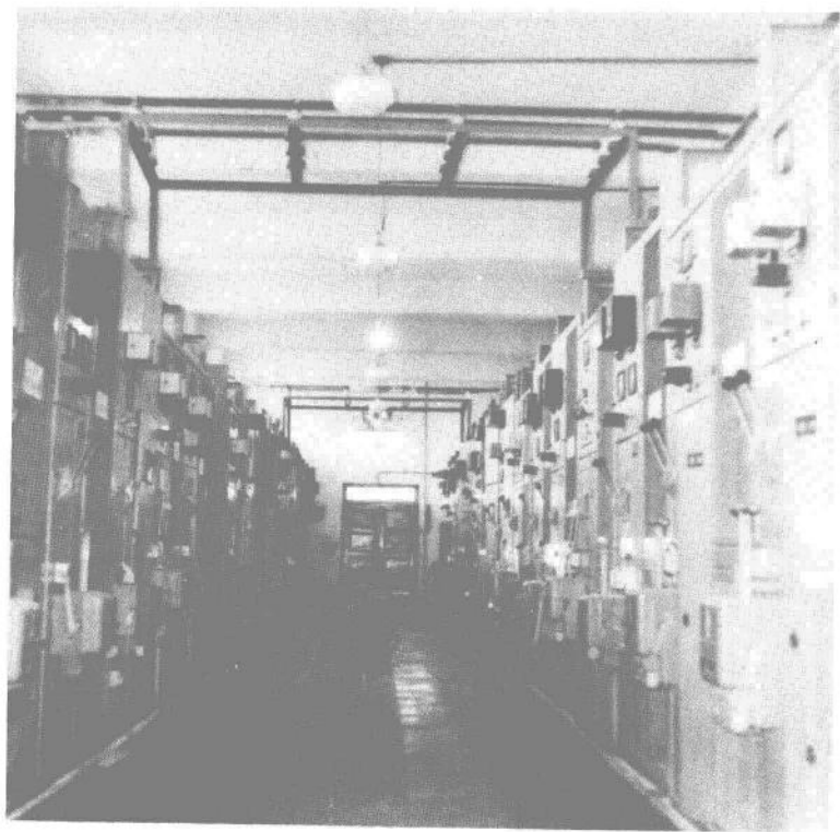
变电所操作间
