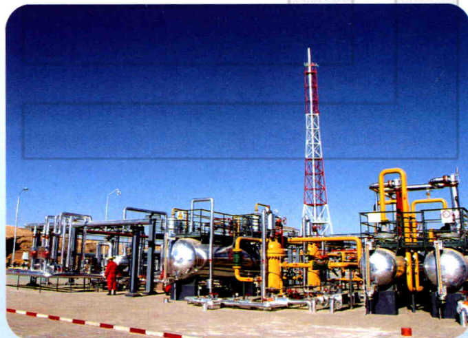
和田河气田集气净化处理站装置一角
