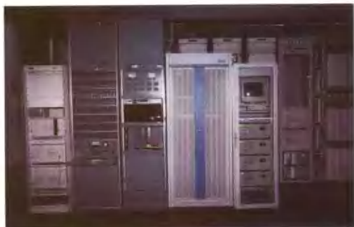
电信交换机房
