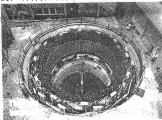
图 2 Höljebro 水电站的 Powerformer 的定子
