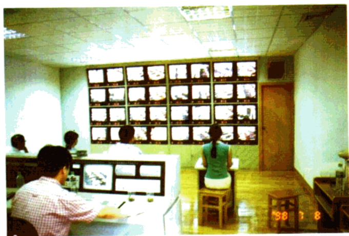
武昌实验中学电子监控考场控制室
