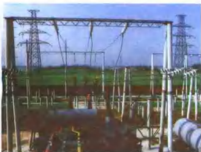
△ 陈庄110KV 变电站
