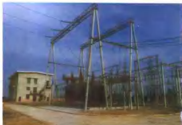
▽ 青台220KV 变电站
