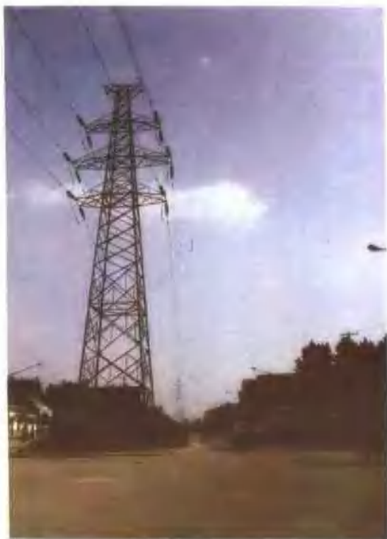
◁南阳市文化路110KV 输电线路
