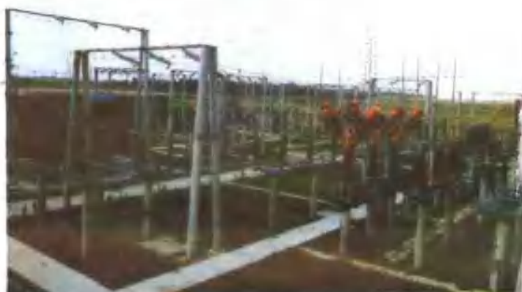
▷ 唐河110KV 变电站
