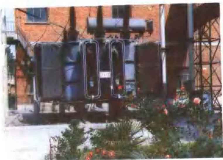
◁建西110KV变电站
