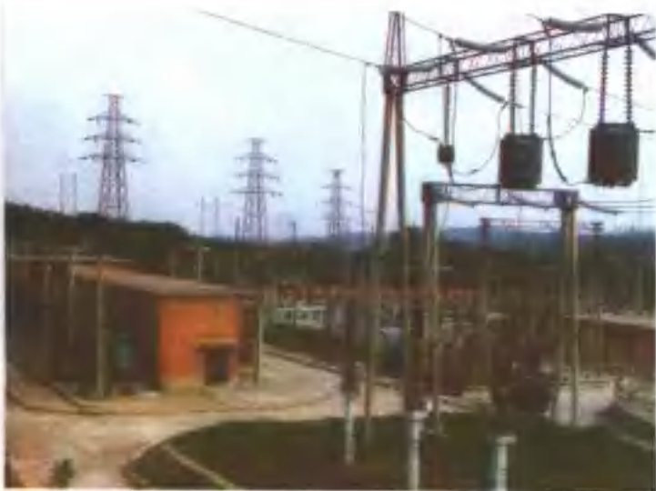
◁ 遮山220KV 变电站
