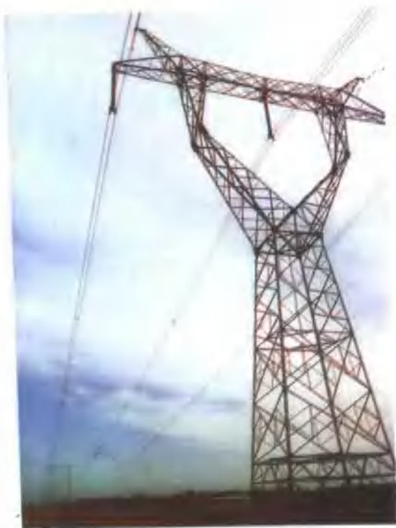
▽平顶山至武汉500KV 输电线路
