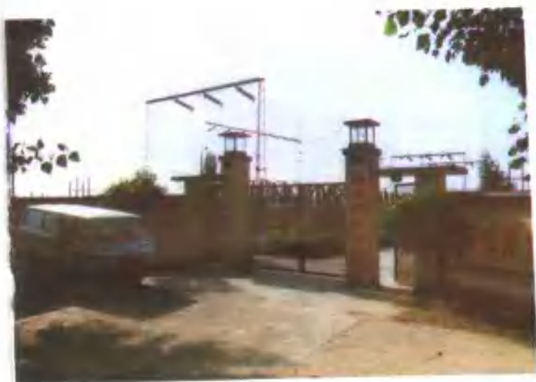
△香花110KV变电站
