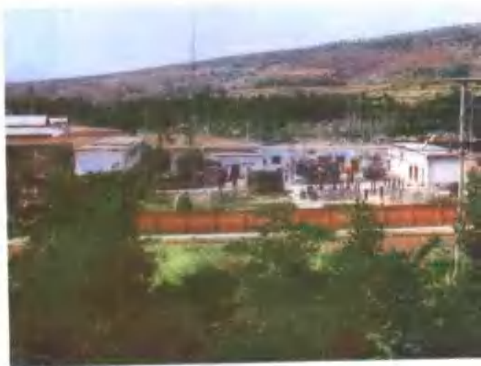
▷冬青110KV变电站
