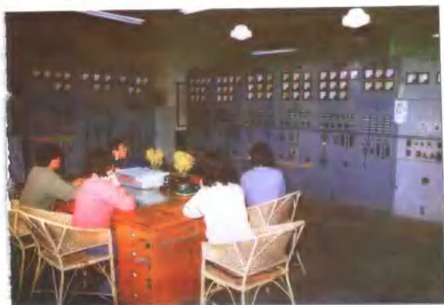
◁ 南阳电厂控制室
