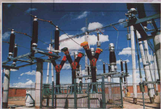
农电网改造，建成110千伏变电所与全疆联网
