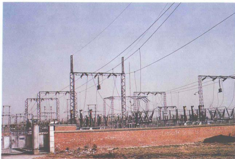
8.1982年张建武、翟明礼任书记、县长时建成的十一万伏变电站
