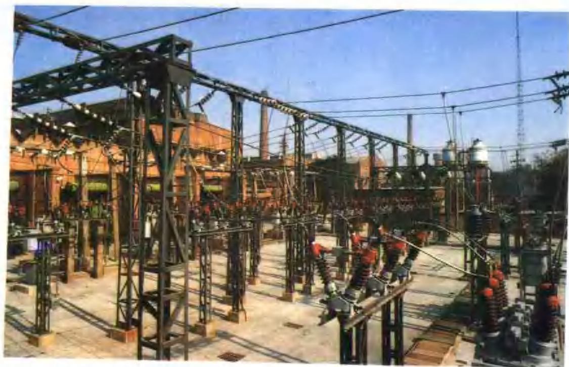
改造后的供电枢纽
