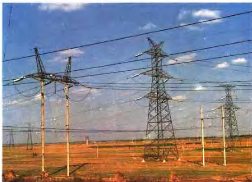
220千伏输电线路
