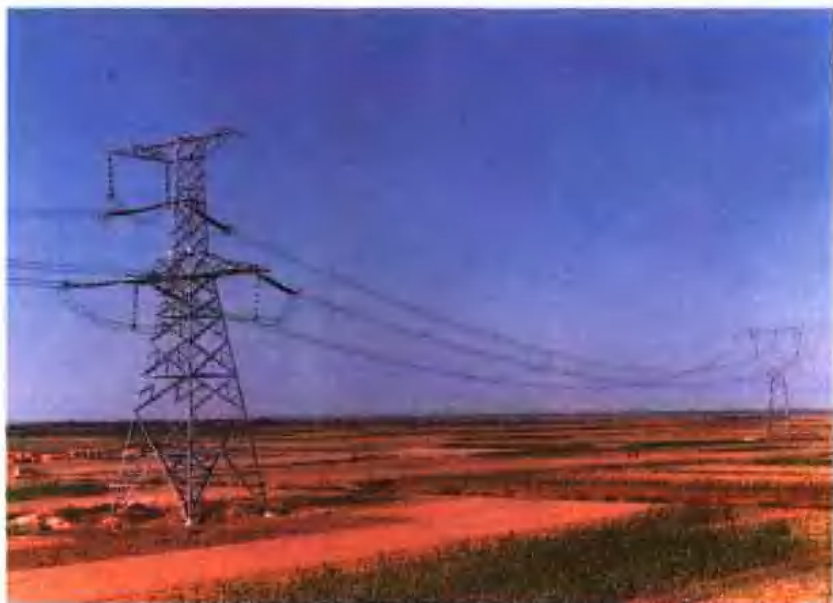
邹潍500千伏输电线路
