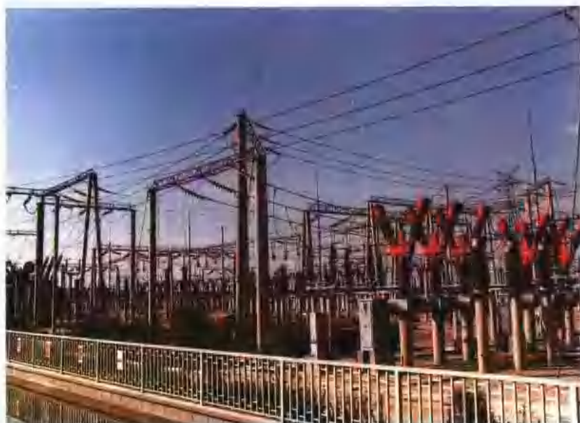
220千伏贾庄变电站
