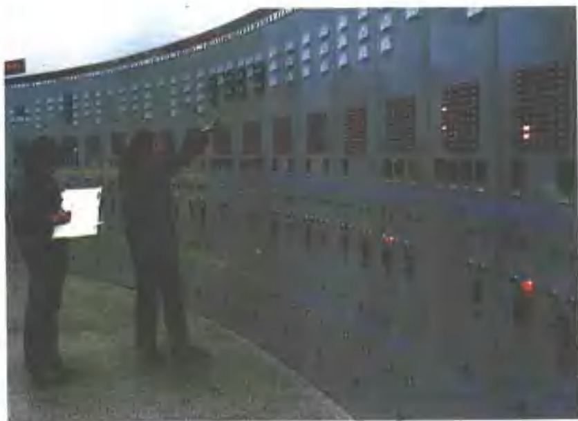
500千伏潍坊变电站主控室
