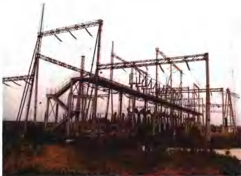
220千伏泉河变电站
