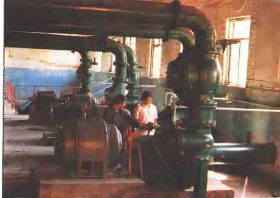
→ 动力水泵主泵房
