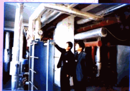
中央空调机房
