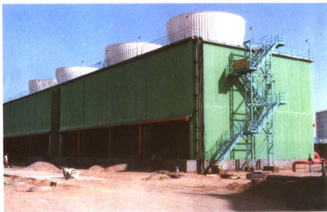
塔里木石化厂凉水塔
