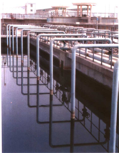
泽普石化厂污水处理厂曝气池
