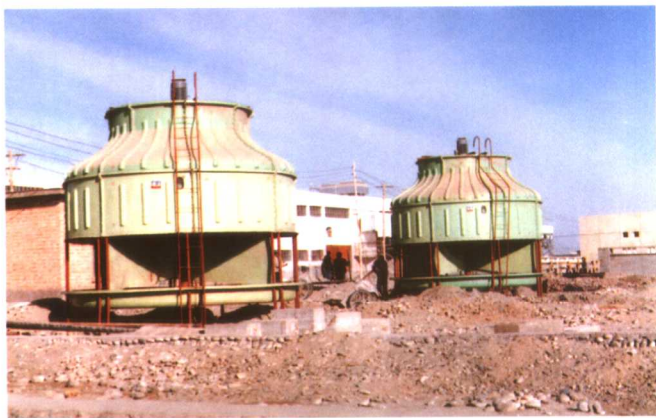
泽普石化厂玻璃钢冷却塔
