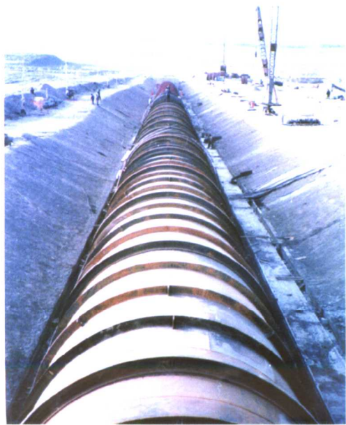
喀什电站钢压力管道
