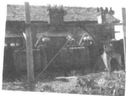
董庄10千伏配电装置
