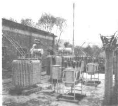
中渡店变电站
