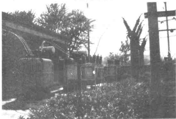
息县中渡店变电所主变
