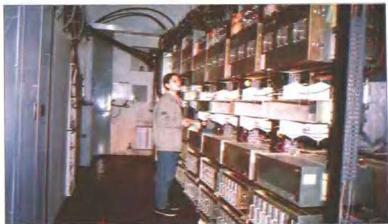
移动通信机房
