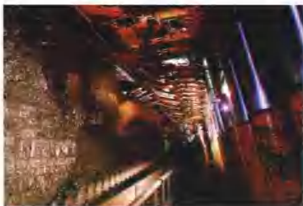
综合机械化采煤工作面
