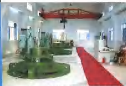
装机容量750千瓦的三金水电站厂房一角。
