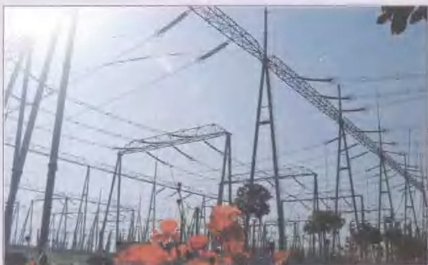
奉贤南桥50万伏变电站。
