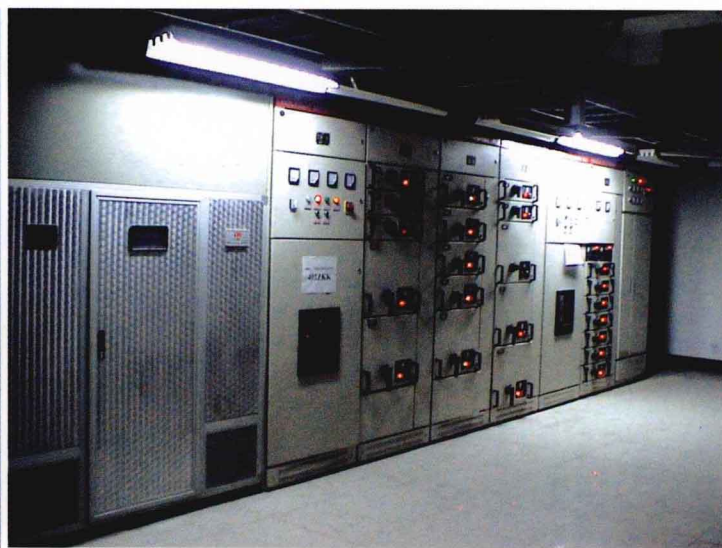
牛栏口水电站配电室
