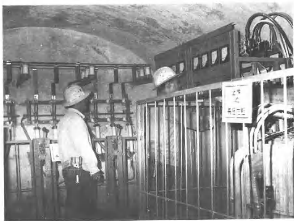
洪山矿区井下配电室一角
