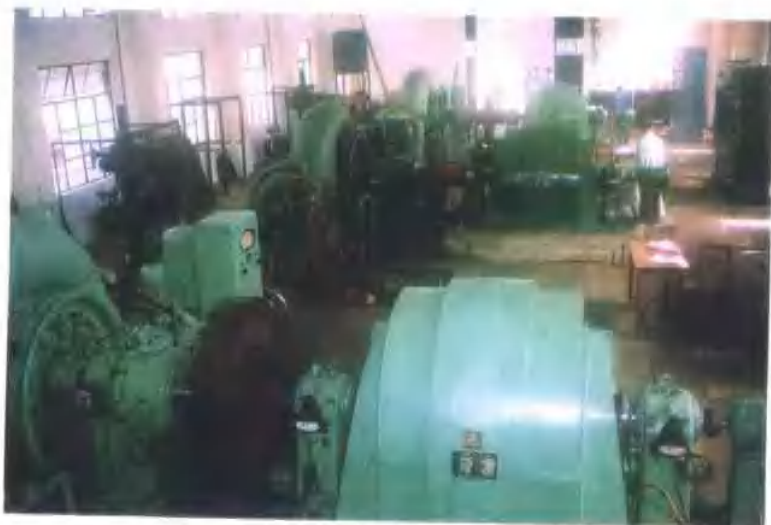
江湾水库坝后电站发电设备
