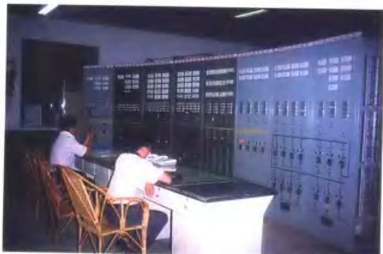
万宁110KV变电站控制室
