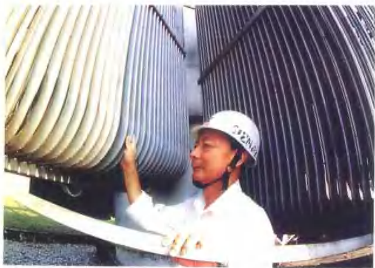
翁宏平经理检查供变电设备(转自《崛起的万宁》)
