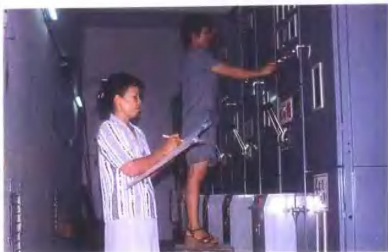
万城供电所控制室
