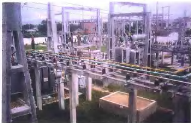
公司供变电设备之一
