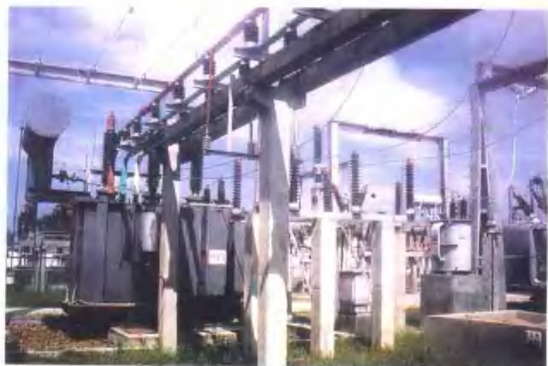
公司供变电设备之二
