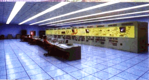
冀东水泥股份公司中央控制室
