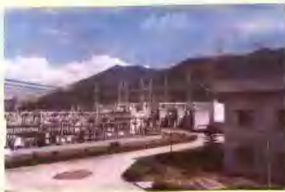
我省第一座 500KV 江门变电站雄姿
