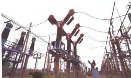
220KV 昌邑变电站 Changyi 220KV substation
