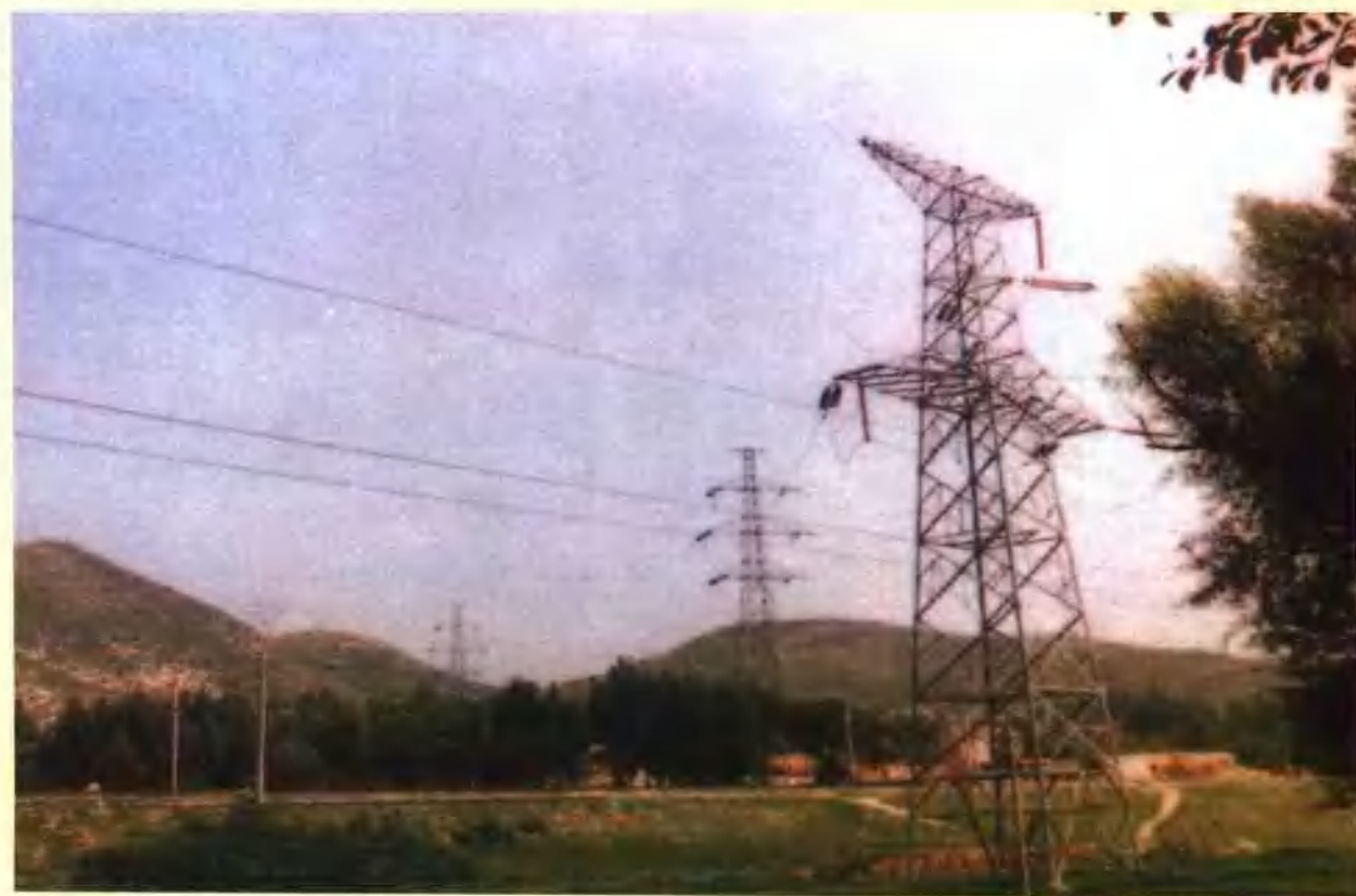
下花园境内的京—侯 220 千伏线路
