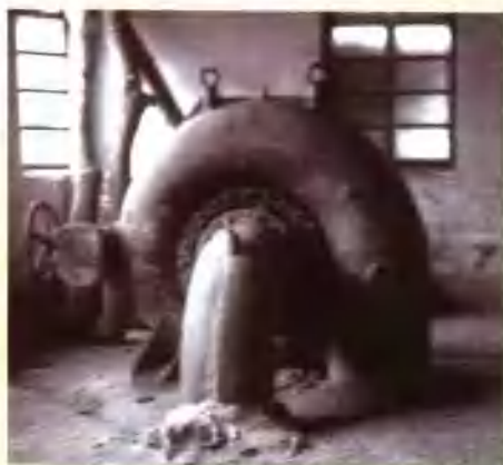
农村小水电站机组
