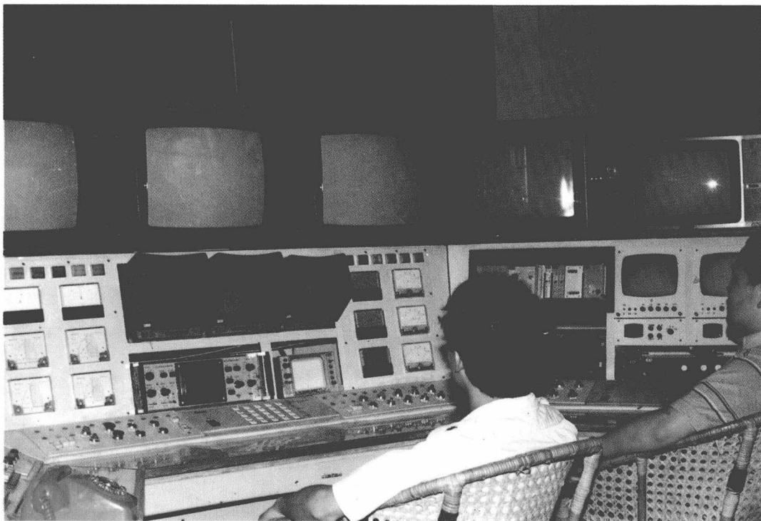
电视调频发射机房控制中心
