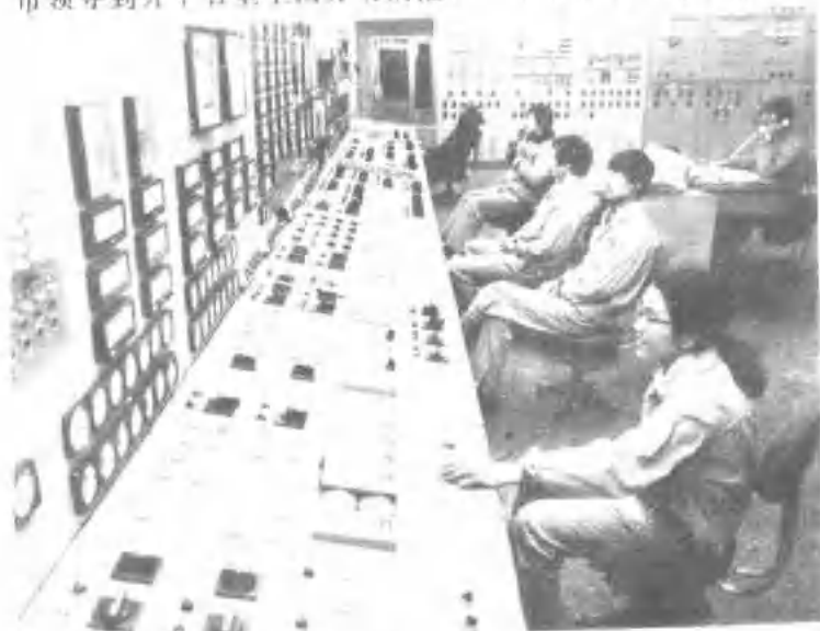
唐山发电总厂中心控制室一角。
