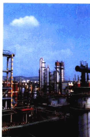
山东鲁南化肥厂净化车间
