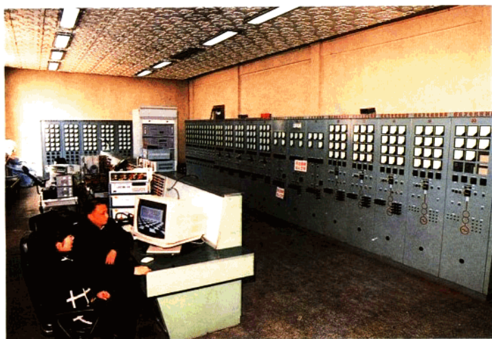
省重点实验室：电力系统动态模拟与数字仿真实验室动模主控室
