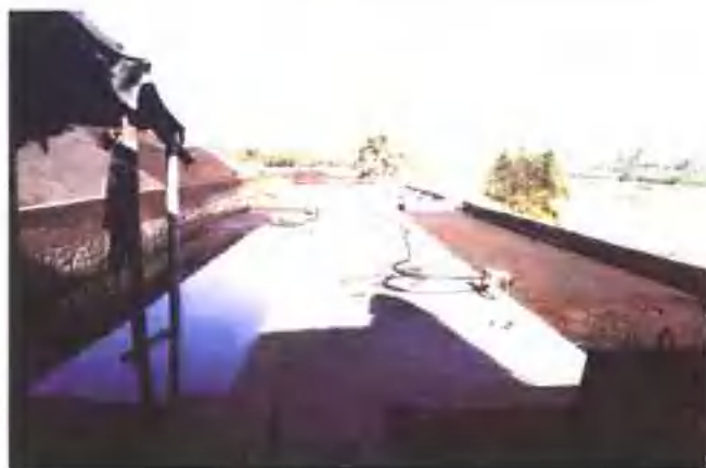
南靖磷肥厂硫酸车间废水处理设施
