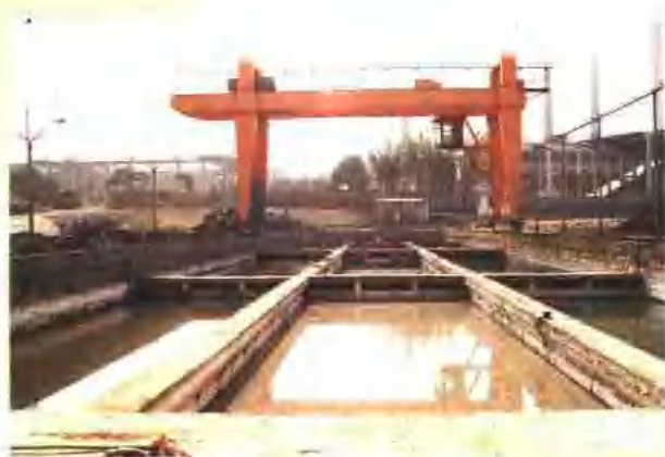
漳州糖厂锅炉冲灰冲渣水治理设施
