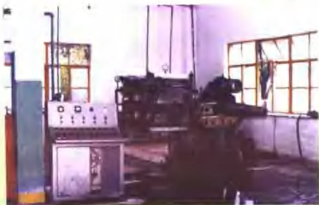
漳州国际铝容器有限公司废 水处理设备：板框压滤机
