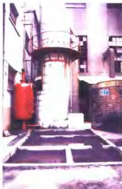
漳州市北区集中供热站文丘里麻石水膜除尘器及烟灰沉淀池
