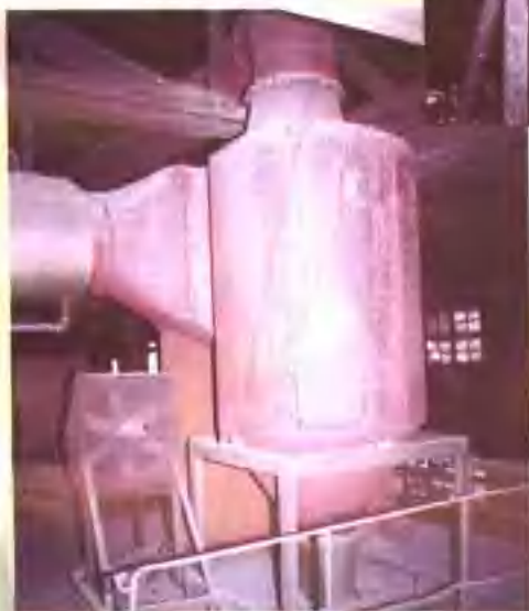
龙溪机器厂冲天炉治理设施：干式旋风除尘器
