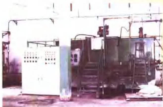
漳州国际铝容器有限公司废水处理设备，三段处理槽
