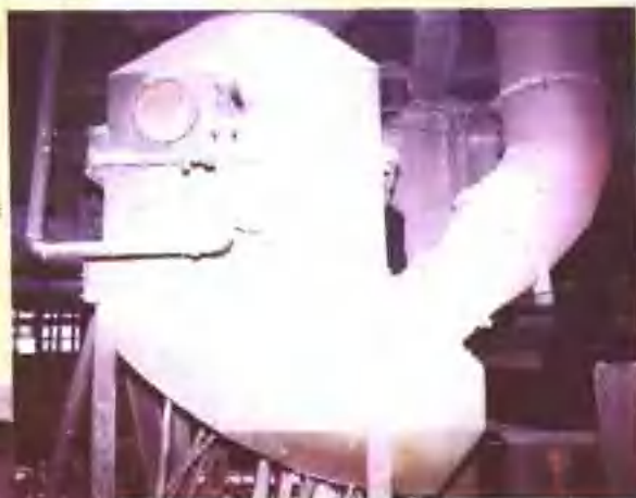
龙溪机器厂冲天炉治理设施：水膜除尘器
