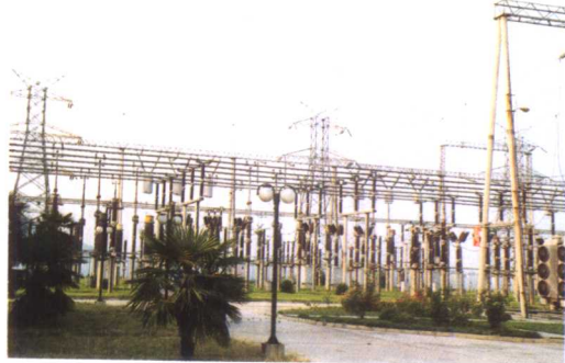
由我公司安装的 220KV 变电站
