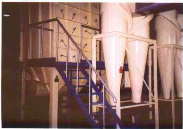
脉冲除尘器起到 消除烟味、减少污染、 净化空气、美化工厂 周围环境的作用
