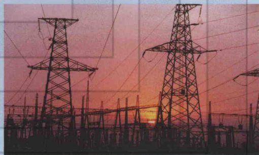
220千伏奎屯变电站设备区
