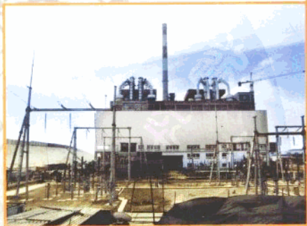
已投入运营的主厂房和升压站
