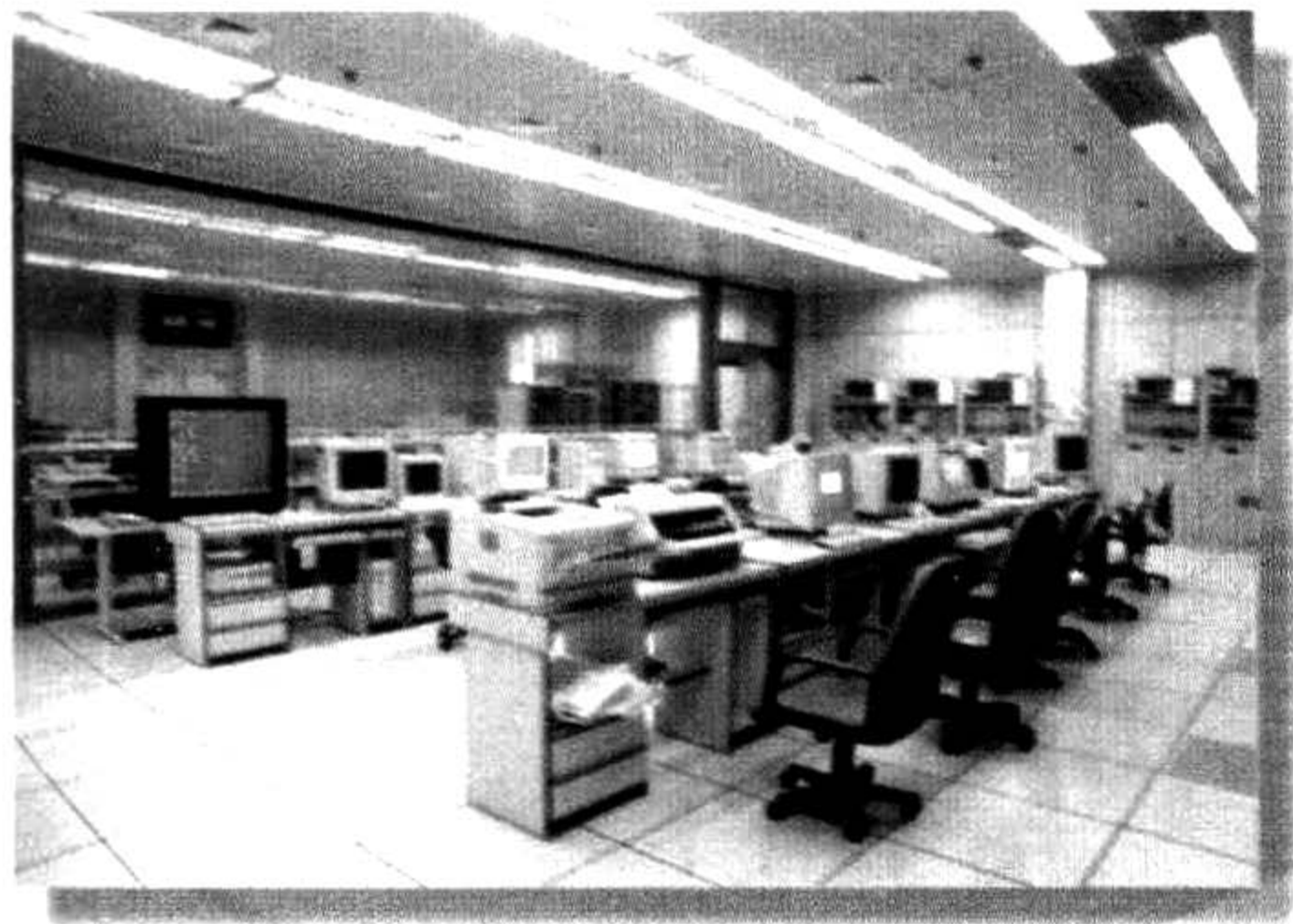
贵州铝厂网络中心机房
