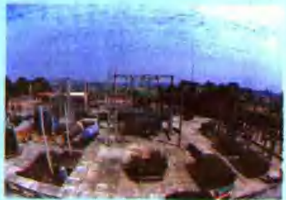
▲110kV 变电站一景
