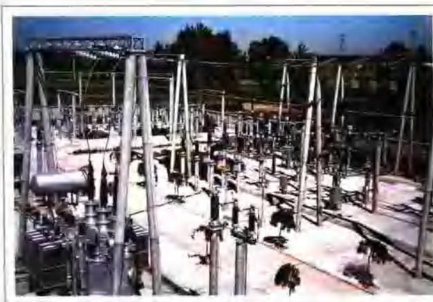
耿庄 110 千伏变电站
