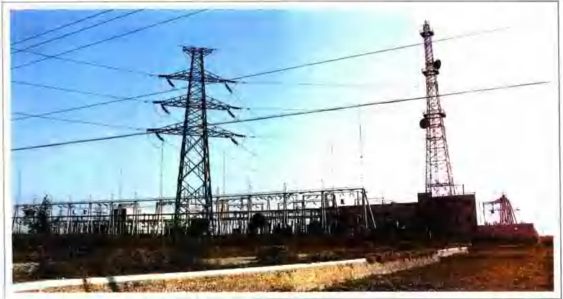
隆尧 220 千伏变电站
