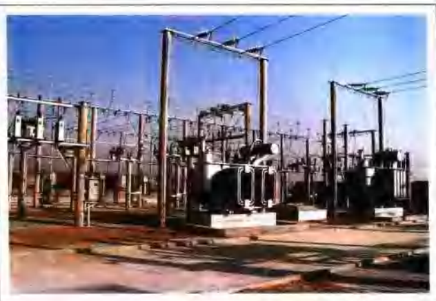
张庄 35 千伏变电站
