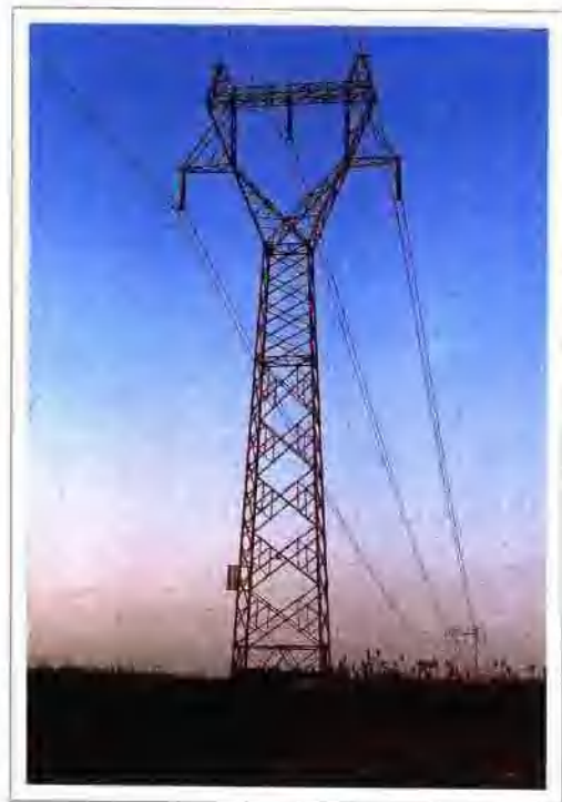
王隆 220 千伏线路
