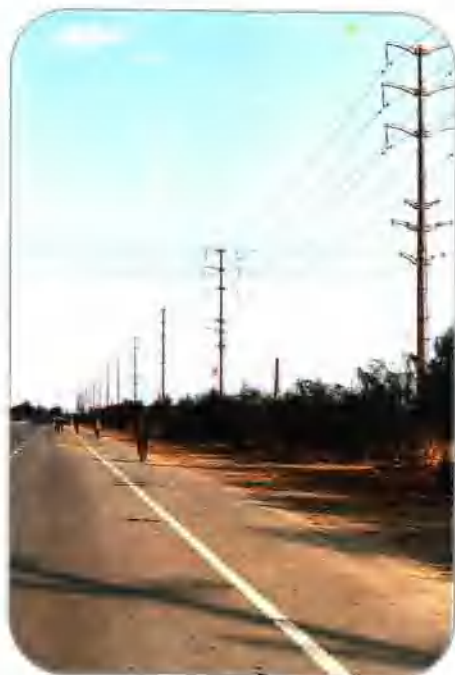
35 千伏、10 千伏同杆架设线路
