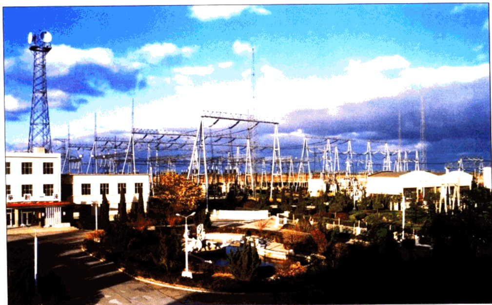
■ 1986年投运的 全省第一 座500千伏变电站—— 潍坊 变电站
