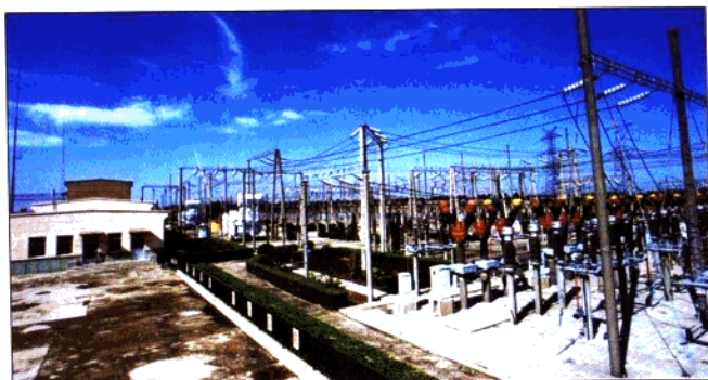
1975年投运的 潍坊市第一 座220千伏变电站—— 贾庄 变电站
