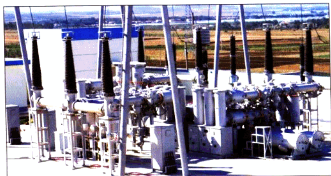
潍坊市科技含量最高的 220 千伏变电站—— 宝都 变电站
