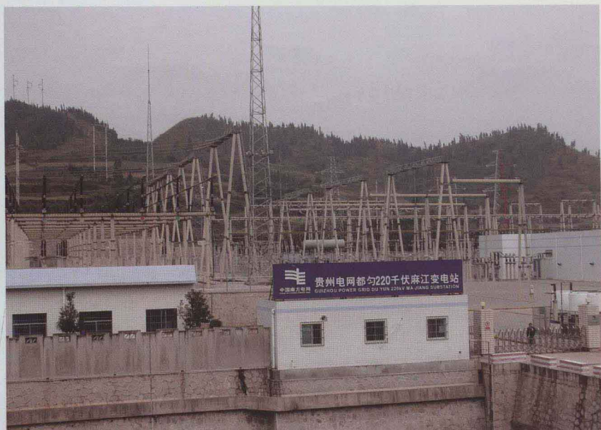
新建的220千伏麻江变电站
