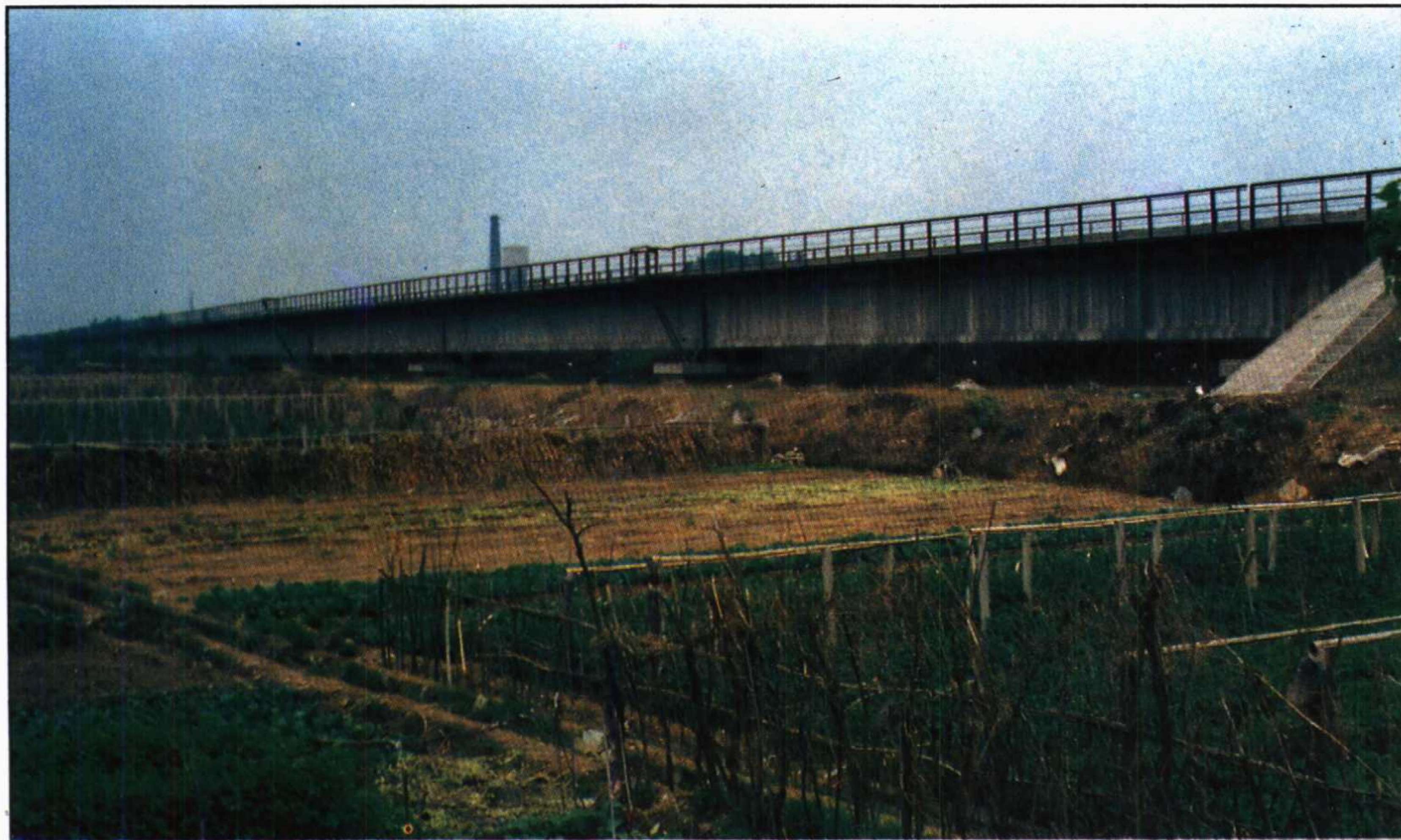
◁津浦铁路泰安站南端路 基塌陷地区双线大桥， 全长 806.32 米
