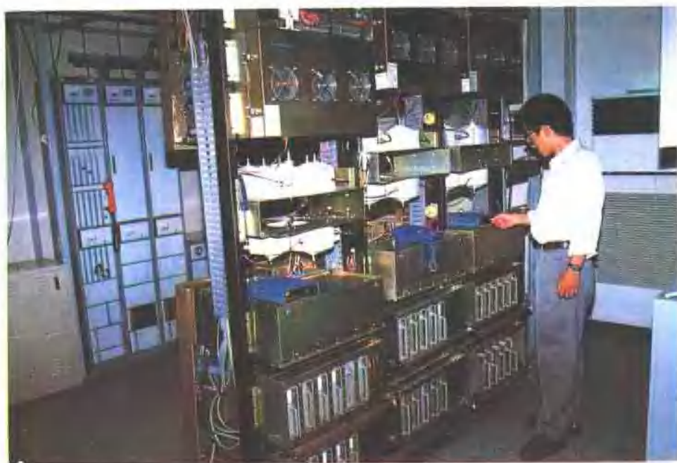
移动通信机房
