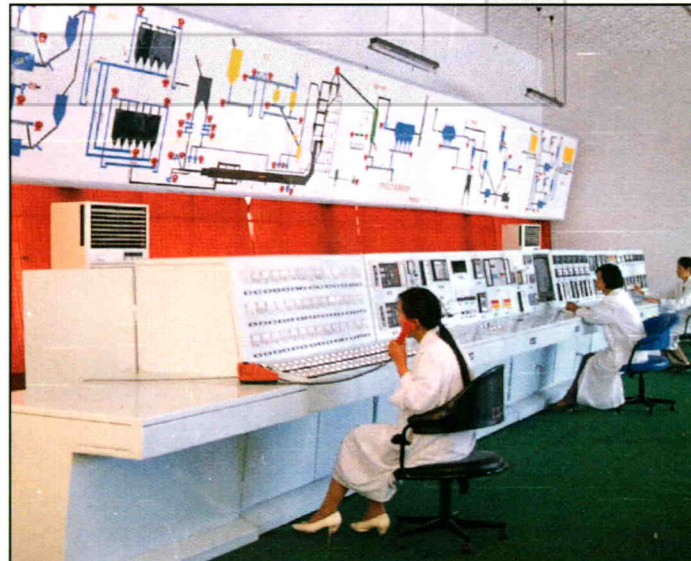
市第一水泥厂主控机房
