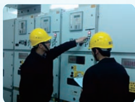
4.操作高压开关前确认开关状态
