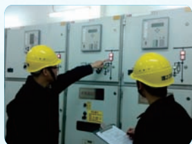
7.高压开关摇进后，再次确认高压开关状态
