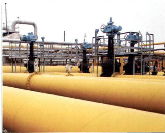
天然气集输管道、调节阀组
