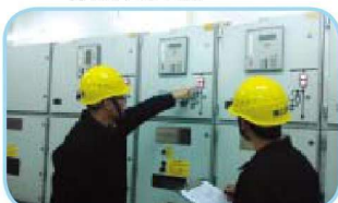
7. 高压开关摇进后，再 次确认高压开关状态
