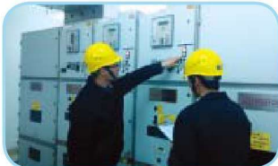
4. 操作高压开关前 确认开关状态
